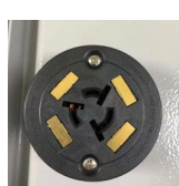
IPX6 - Evidência de NÃO ingresso de água na tomada do relé fotoelétrico
